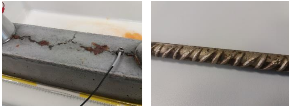
Figura 7. (Izq) Detalle de una barra al final del proceso de corrosión. Se aprecian subproductos de la corrosión que salen de la grieta. (Dch) Barra una vez desprendido el mortero adherido y la capa de óxidos.
