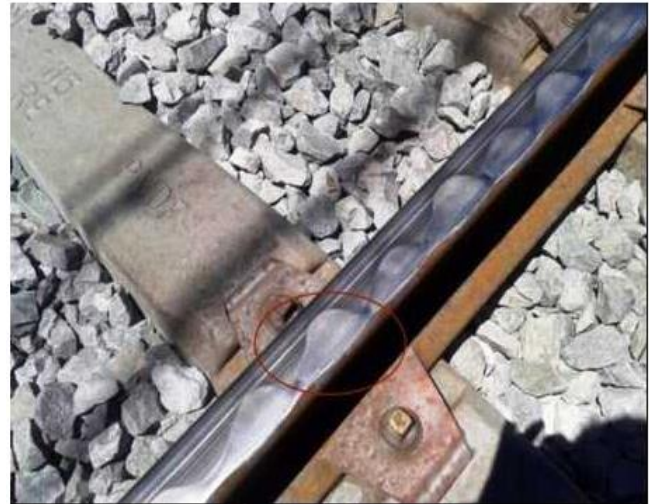
Figura 5. Desgaste ondulatorio en un raíl.
